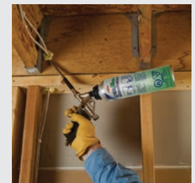
Traverses de fils électriques
